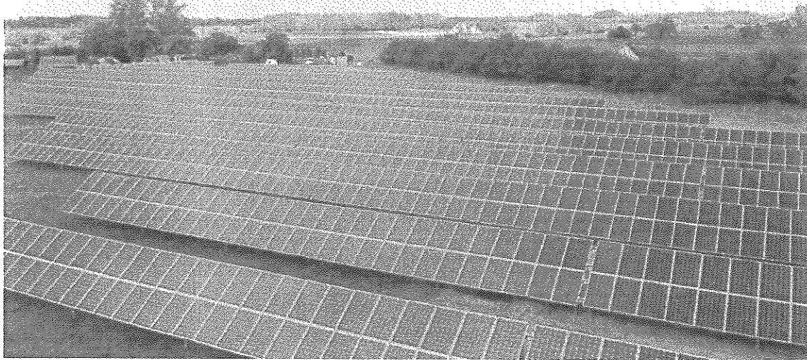
A Pusztaszeren 2012-2013. évben megvalósult, naperőmű (IntervWatt Kft. gyártmánya) (Forrás: Az IntervWatt Kft. bemutatkozó anyaga.)
