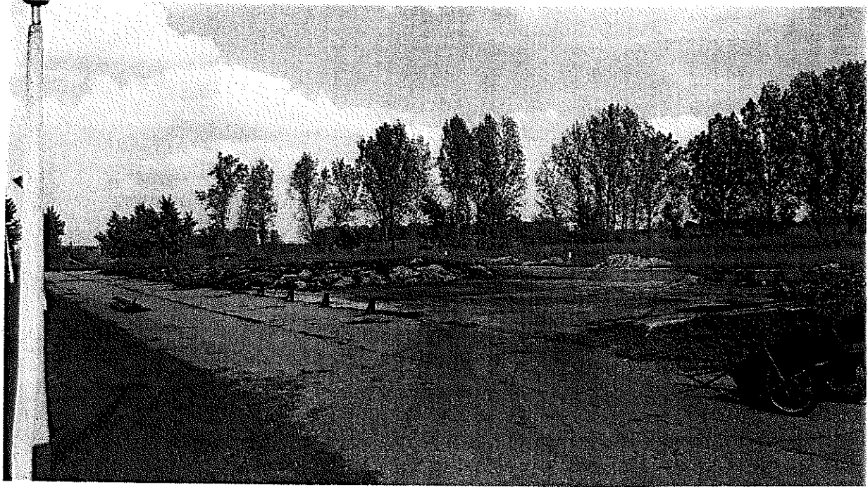
22. ábra. Jelenleg rendelkezésre álló iszapszikkasztó
