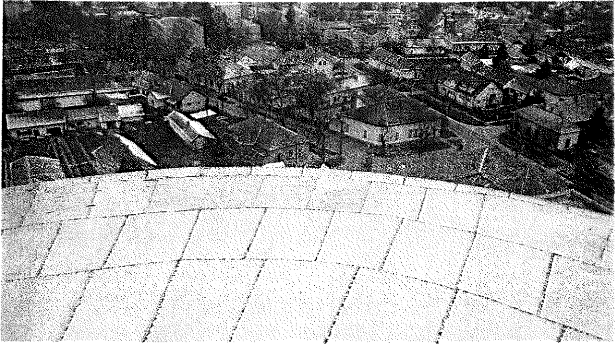
5. ábra. 2018. januári burkolat fölszakadás
