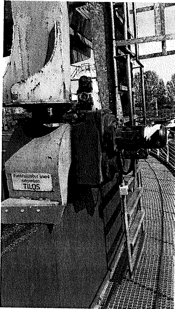
20. ábra. Kotróhíd hajtóműve villanymotorral
